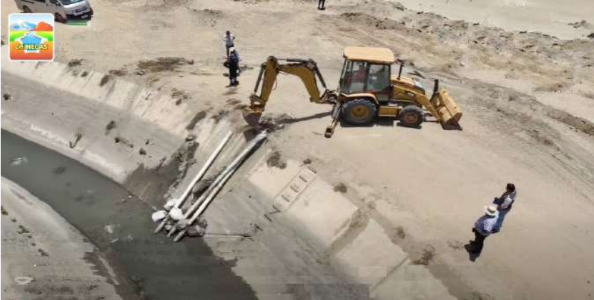
El Proyecto Especial Chinecas retiró una serie de sifones instalados de forma ilegal en el canal principal del sistema hidráulico, tras detectar
