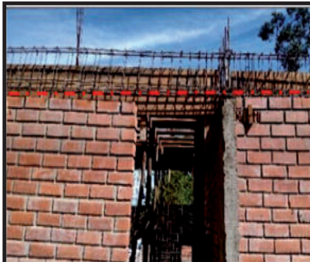
En la imagen se observa que los muros no mantienen la horizontalidad respecto uno del otro.
